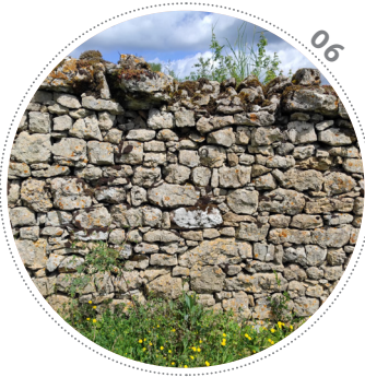
06 Ce mur de soutènement prolonge le murger principal de La Rochette. Installé sur une courbe de niveau, son appareillage soigné fait usage de pierres de dimensions et de formes très diverses, et semble avoir déjà fait l'objet de réfections.
