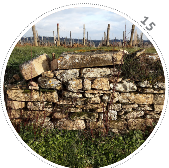
Pierres taillées en moellon et grosses dalles formant la couverture provenant sans doute d'une carrière.
