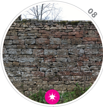
08 Parement en Opus Quadratum du mur de soutènement du secteur Les Chailloux. On peut voir une certaine similitude d'aspect avec l'image précédente. Seule la couverture est différente, puisque dans le cas de Chevigné de lourdes pierres viennent finaliser la tête de mur.
