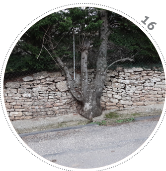
Mur de clôture d'un jardin déformé par la pousse d'un sujet. Cet exemple montre bien la capacité des structures de pierre sèche à se déformer et s'adapter à son environnement.
