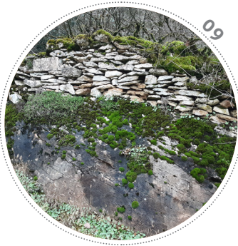
Cet ouvrage trouve son assise sur la roche mère. La morphologie du parement continu de la muraille ne s'interrompt pas pour autant. La hauteur de la clôture initiale est prolongée au dessus de l'affleurement.
