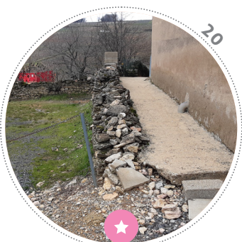
Un des deux chemins de traverse reliant la rue du Plan avec les parcelles de vignes. Ces venelles sont bordées de murs de pierre sèche ou de nouveaux ouvrages en maçonneries liées au mortier.
