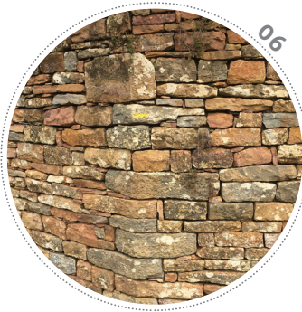
06 Parement en Opus quadratum , larges moellons taillés et posés en assises régulières. Des pierres de taille importante rigidifient le chaînage d'angle.
