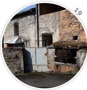
Cette source ou puits est accessible côté rue au hameau de la Truche. De belles pierres levées marquent le devant de l'ouvrage et une grande lave couvre l'ensemble. Cependant les parties latérales ont fait l'objet de reprises au ciment peu valorisantes.
