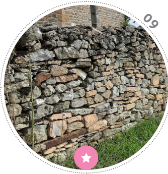
09 Mur de soutènement routier présentant une déformation importante avec des risques d'effondrement. Le mur marque la limite Nord d'un petit clos au cœur des habitations.
