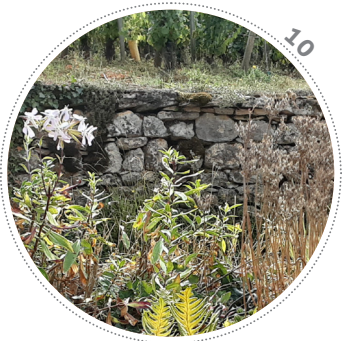
Mur de soutènement au Champ Rocher formé de moellons de grande taille en partie basse, posés en opus incertum, recouverts de massives couvertines calées par plusieurs rangées de pierres plates.
